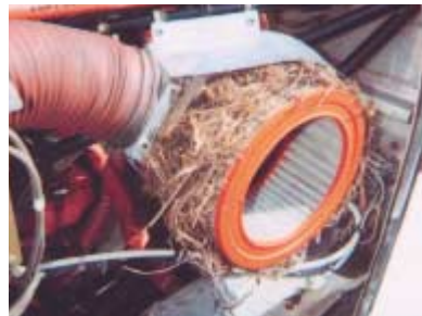
Ein Vogelnest im Luftfilter ist schwer zu erkennen
